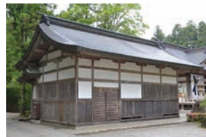
修理前の神饌所
