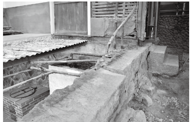
写真6 地下室のボイラーと配管（左脇は竈）
