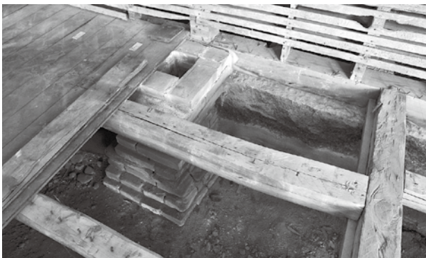
写真7 食堂の床下に配された暖房設備（ボイラーの余熱は温風としても利用されました）
