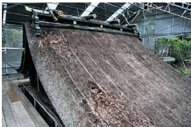
屋根の修理前破損状況
