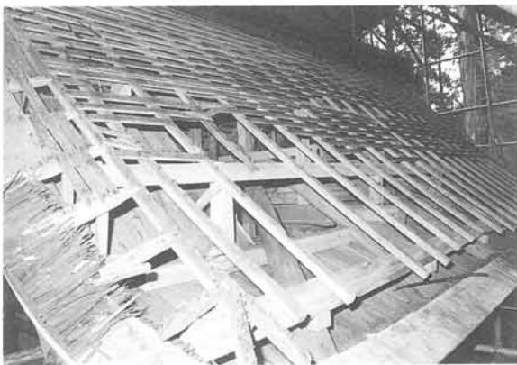
野地の腐朽状況
