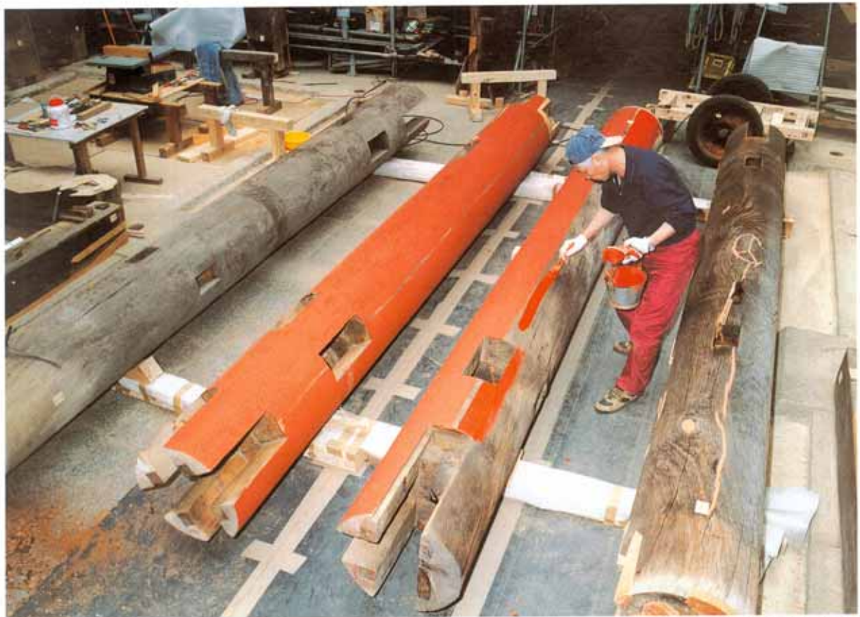
4. 粉河寺大門の塗装状況
