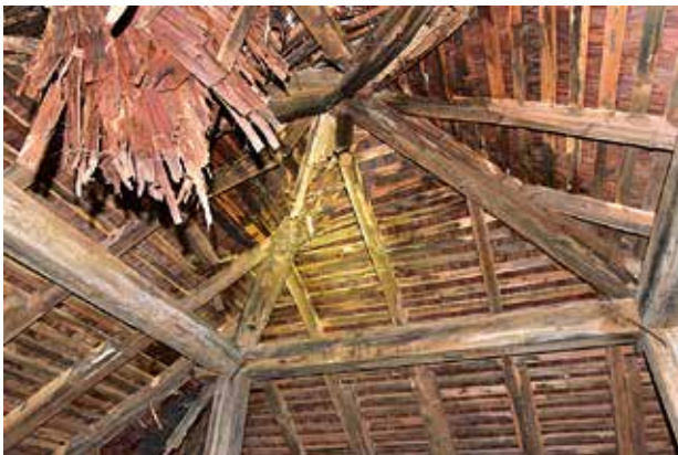
腐朽が進んだ経蔵の小屋組
