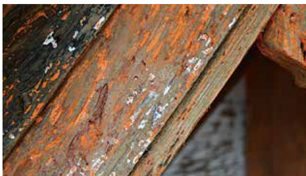
写真3 旧塗装の痕跡
