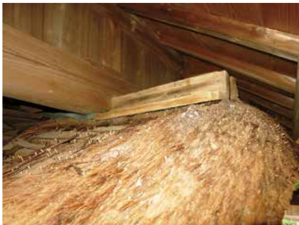
唐破風箱棟の破損状況
