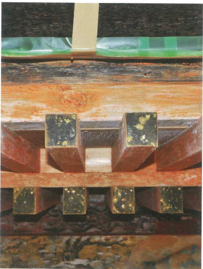
写真4 塗装を掻き落とした状態。茅負の上半分と垂木木口に黒色塗装痕跡が見える。
