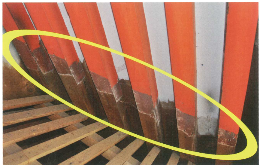
写真8 変色した鉛丹が残存する。
