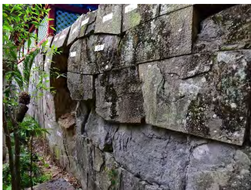
写真1 石垣の破損状況
