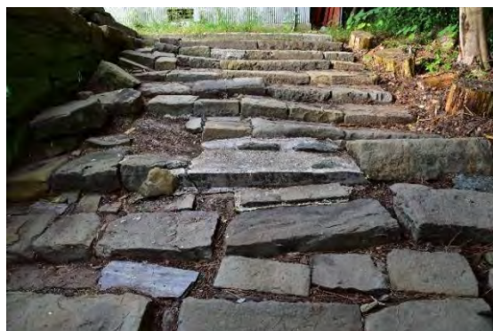
写真4 石階段の破損状況
