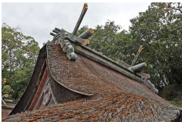
写真4 修理前の屋根面劣化状況(檜皮を打ち留める竹釘が大きく露見する迄に摩耗が進んでいた)
